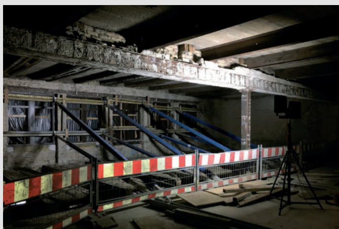
Immer sicher. Während die alte Decke über dem Erdgeschoss Stück für Stück abgebrochen und durch eine neue Konstruktion ersetzt wird, muss die Fassade abgestützt werden.
